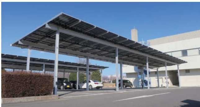
設置台数 20台分 (6台用2基・8台用1基) / 茨城県T市
